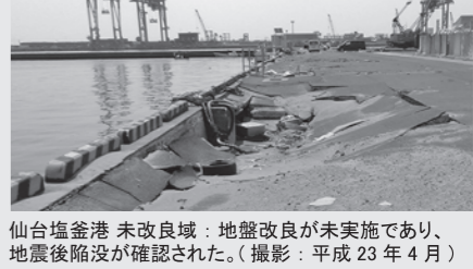
仙台塩釜港 未改良域: 地盤改良が未実施であり、地震後陥没が確認された。(撮影:平成23年4月)
